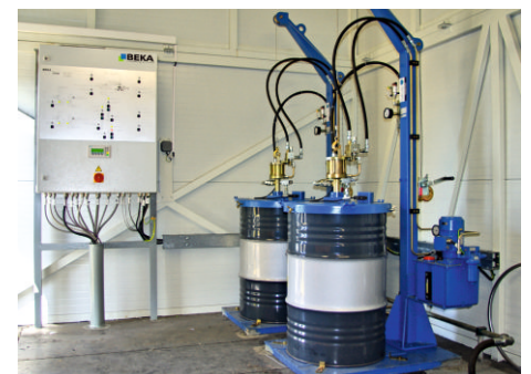
Estación de bombas con bombas de llenado y electrónica
